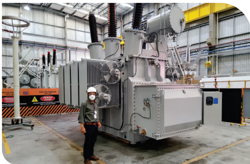
A subestação contará com novos equipamentos de alta tensão, como esse transformador
